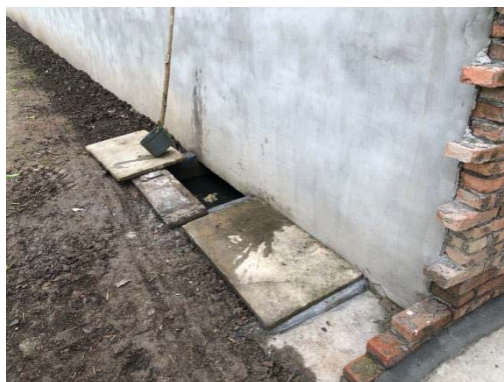
图 3.4 化粪池废水暂存池
