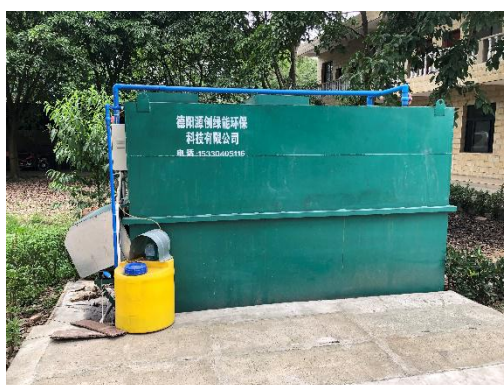
图 3.3 一体式二级生化设施
