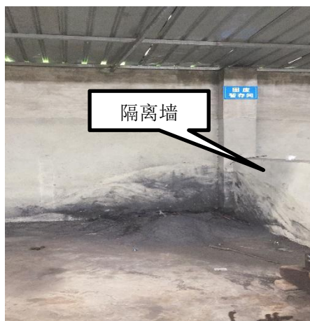
图 3.5 一般固废暂存间
