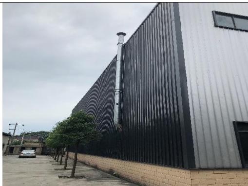
图 3.2 15m 高排气筒
