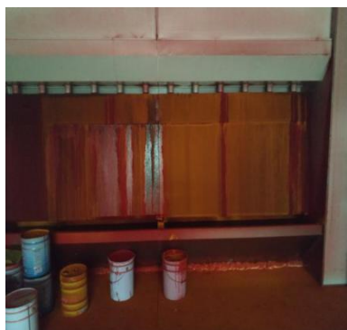
喷漆房水帘装置
