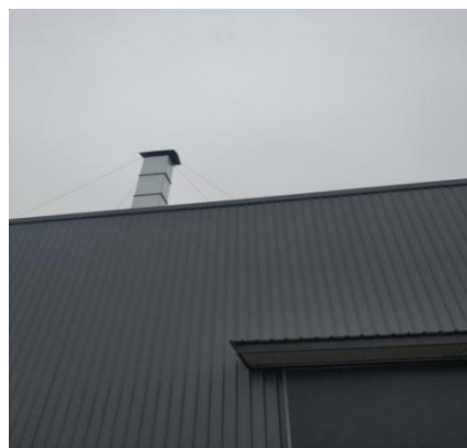
15m 高排气筒（DA001）
