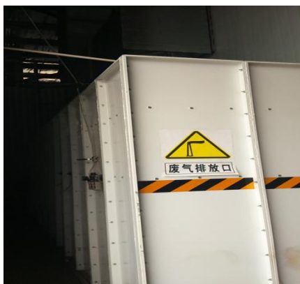
喷砂房滤芯除尘器及废气排放标识
