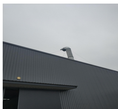
15m 高排气筒 (DA002)
