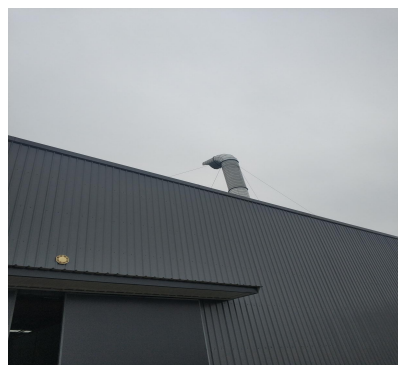
15m 高排气筒 (DA002)
