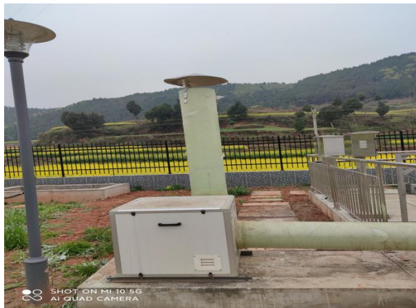
图 3-2 离子除臭装置
