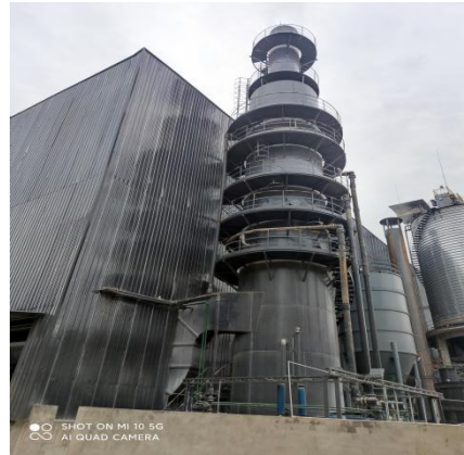
脱硫脱氟装置及排气筒（DA001）
