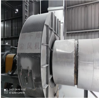
项目烘干布袋除尘装置
