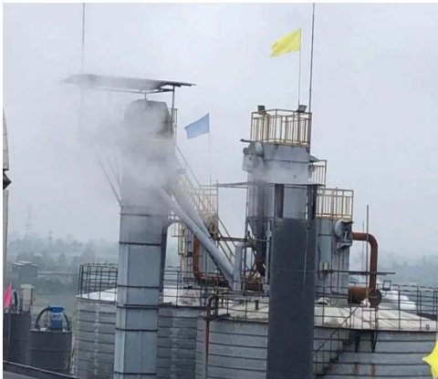
仓顶除尘器排气筒（DA003）
