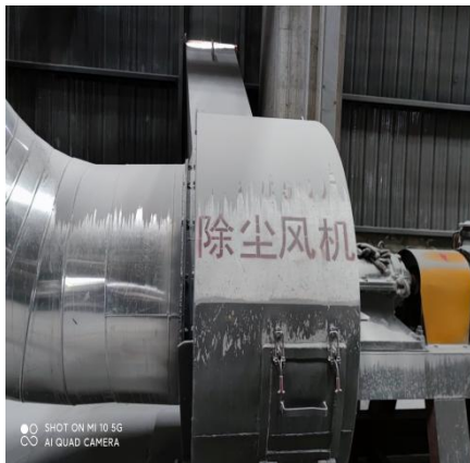
项目磨粉布袋除尘装置
