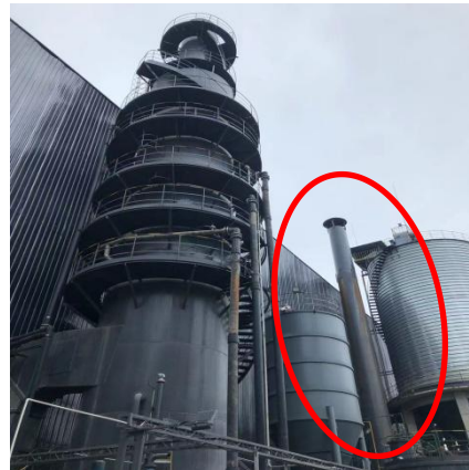
项目磨粉布袋除尘装置排气筒（DA002）
