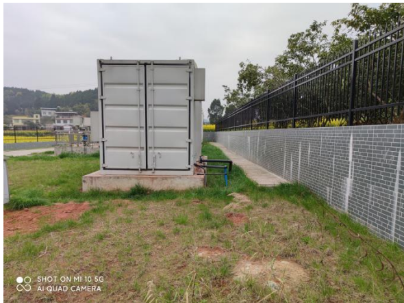
图 3-3 全封闭的一体化污水处理设备
