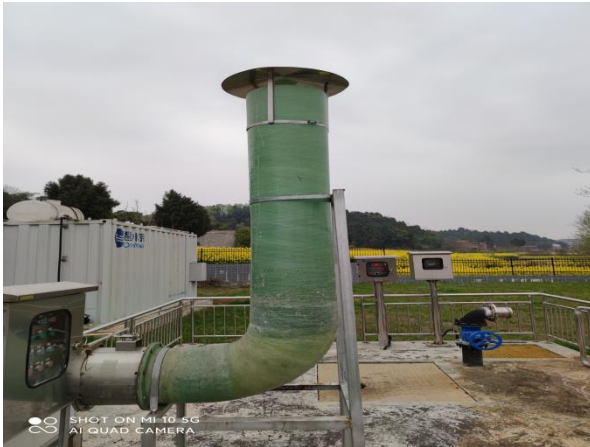
图 3-1 离子除臭装置
