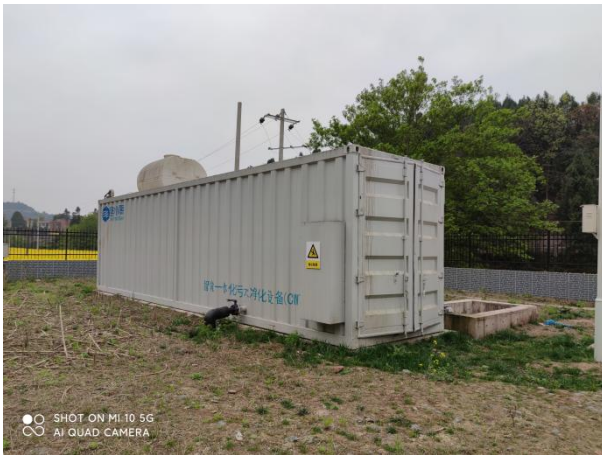
图 3-3 全封闭的一体化污水处理设备
