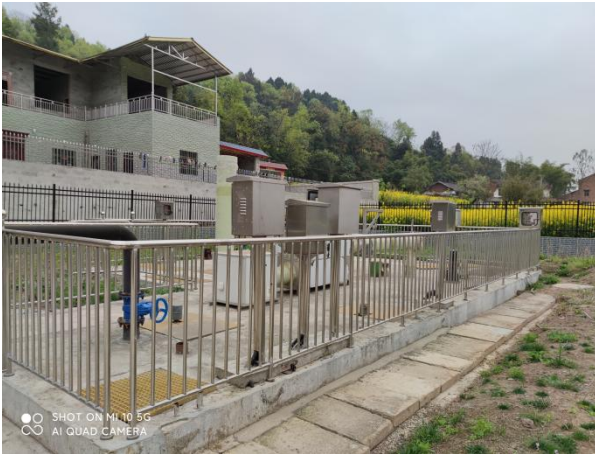
图 3-1 离子除臭装置
