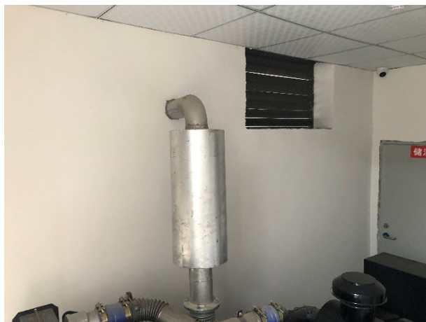
图 3.1 柴油发电机自带消烟除尘设施
