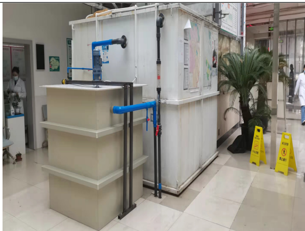
图 3.3 项目污水处理站
