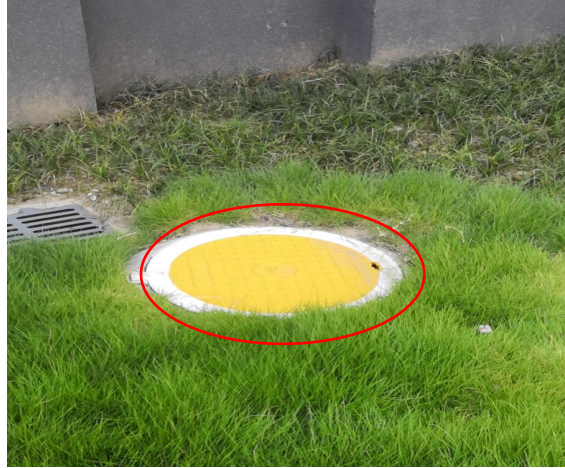
图 3.1 园区内污水管网及预处理池
