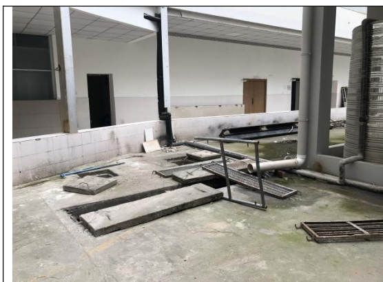
图 3.4 污水处理设施（地下）
