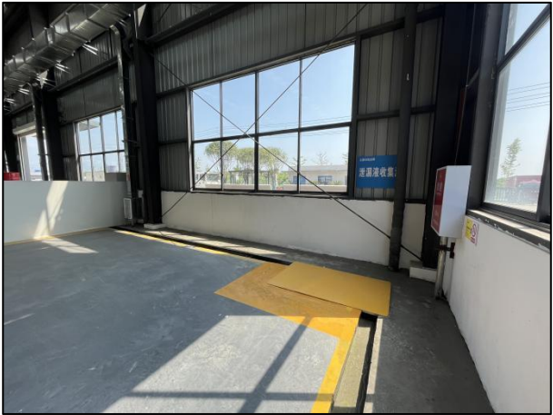
图 3-4 1# 厂房废液收集池及消防栓
