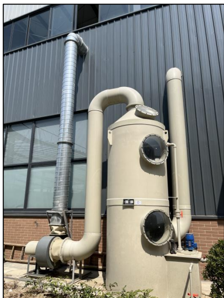
图 3-2 1 号厂房碱液喷淋装置
