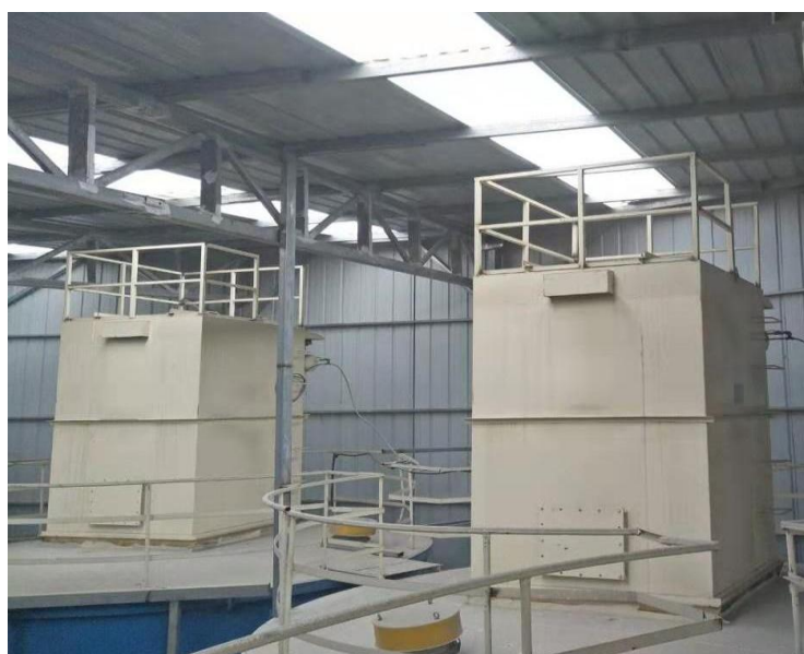
罐仓及仓顶除尘器
