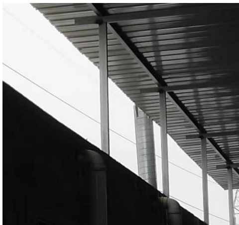
锅炉排气筒（DA004）
