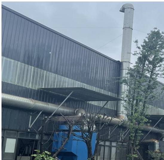
布袋除尘器+15m 高排气筒（DA001）
