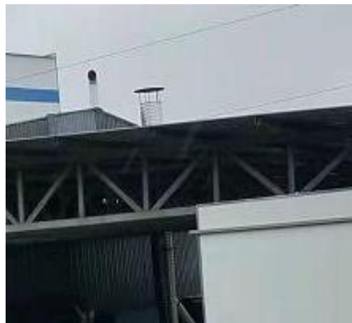
15m 高排气筒 (DA002)
