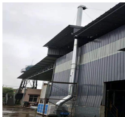
15m 高排气筒 (DA003)
