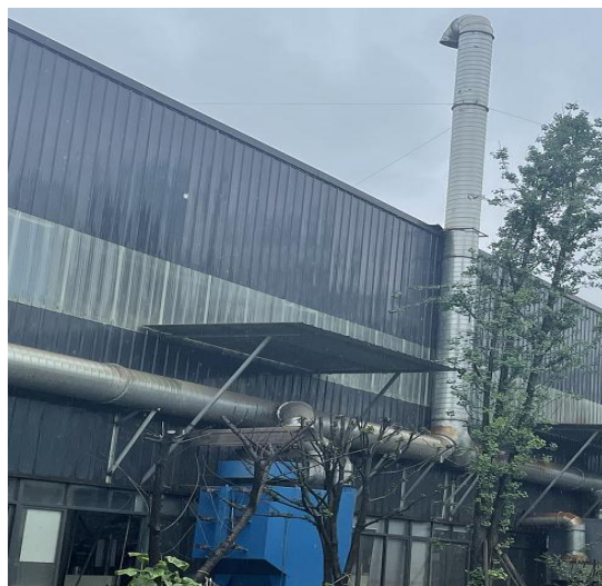
布袋除尘器+15m 高排气筒 (DA001)
