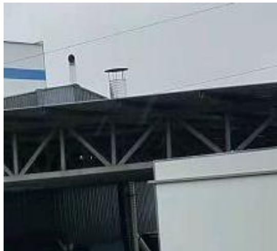
15m 高排气筒（DA002）
