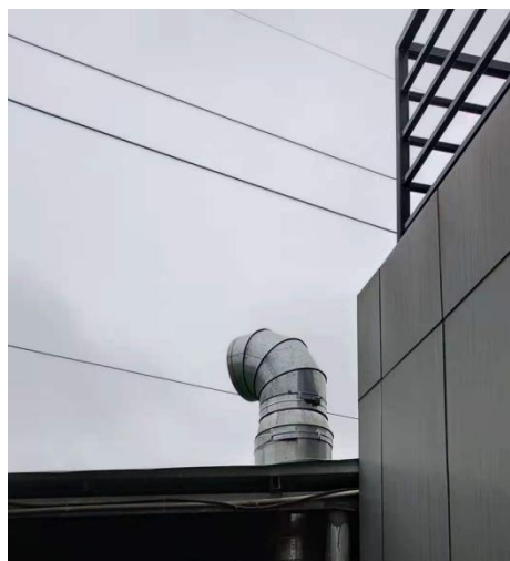
油烟排气筒（DA006）
