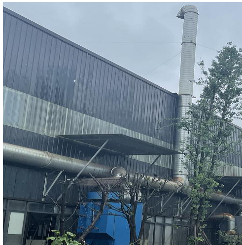
布袋除尘器+15m 高排气筒（DA001）
