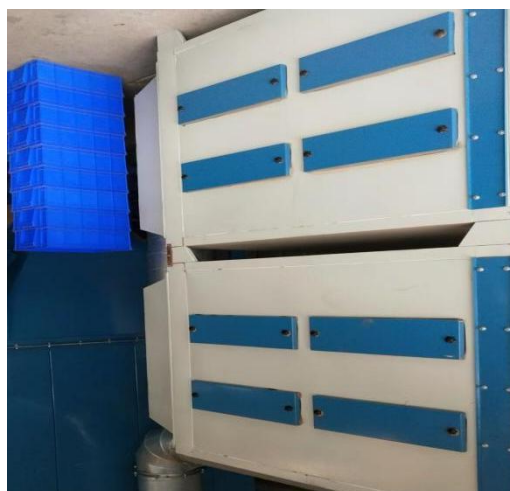
二级活性炭治理装置
