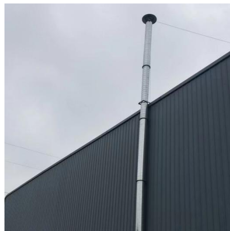
15m 高排气筒（DA005）
