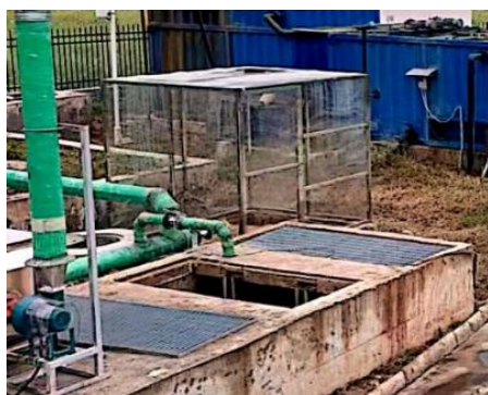
图 3-1 废气收集管道
