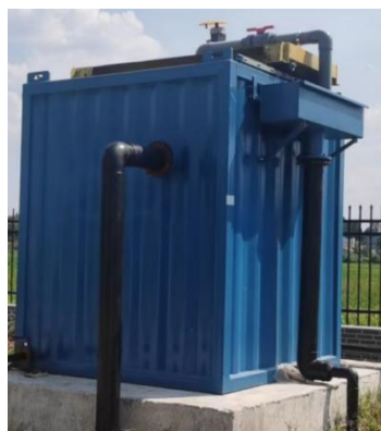
图 3-5 全封闭的一体化污水处理设备
