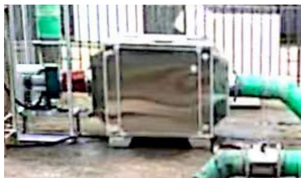
图 3-2 离子除臭装置
