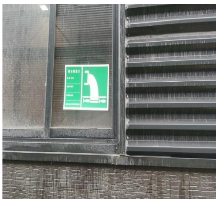
生活污水排放口标识
