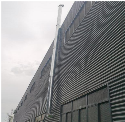
15m 高排气筒
