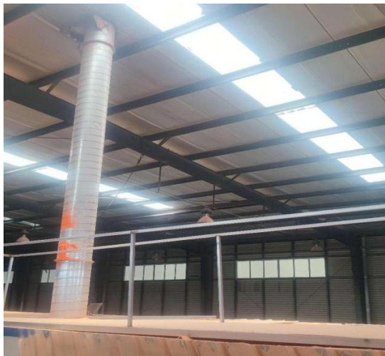
15m 高排气筒（DA001）
