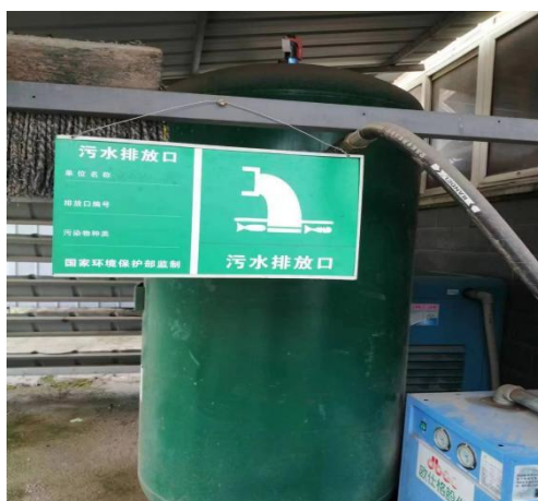
项目生活污水排放口标识
