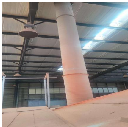
15m高排气筒（DA002）
