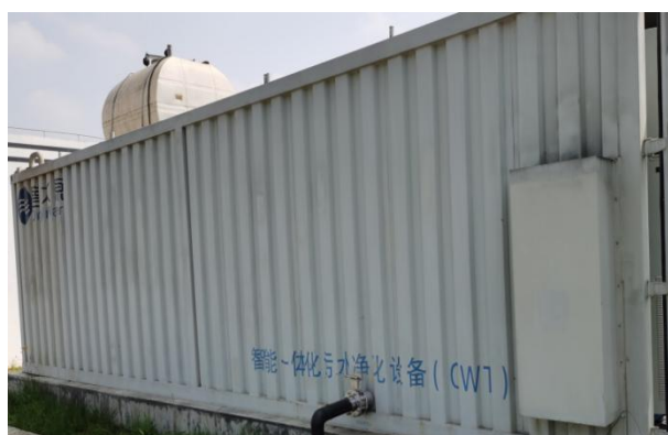
图 3-1 封闭式一体化处理设施
