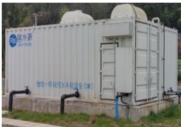
图 3-1 封闭式一体化处理设施
