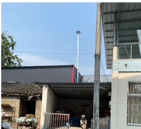
15m 高排气筒（DA002）
